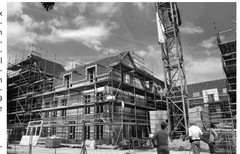
Ter ere van het bereiken van het hoogste punt hees Kees van der Kroon een vlag in de bouwkraan. Fotografie: Ed van Alem
